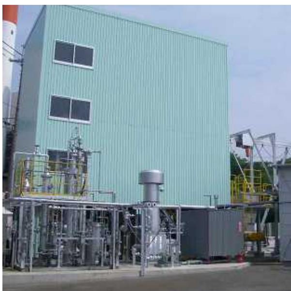
図3 プラント外観
