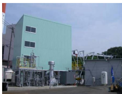
図-2 a) ガス化設備
